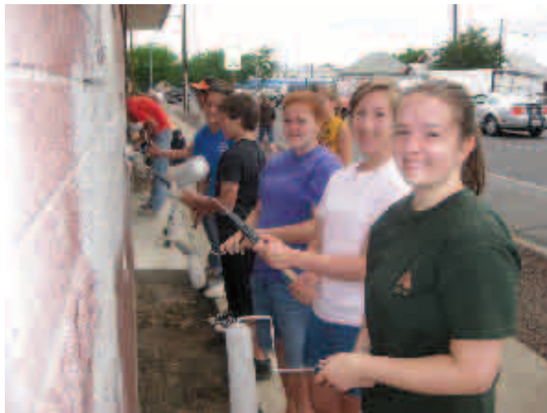
El equipo 2009 de misiones de la FJCN pinta el edificio "Thirst No More" en Yakima, WA.
